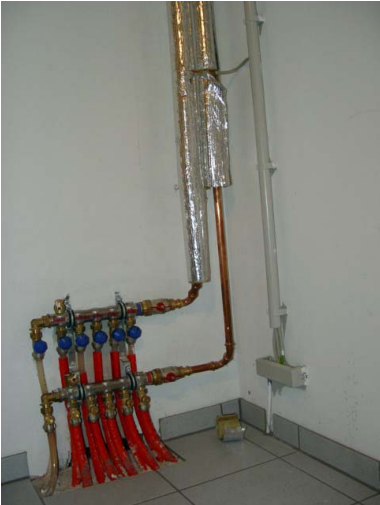
Heizkreisverteiler für EG
