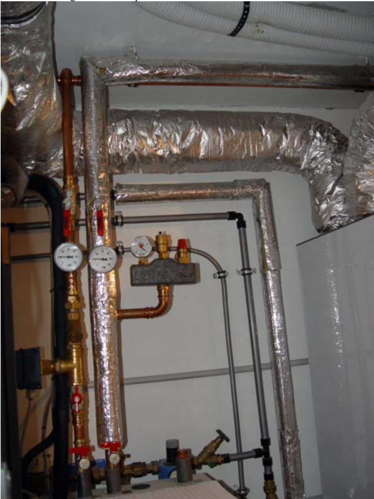
Weiter die Leitungen zum Pufferspeicher
